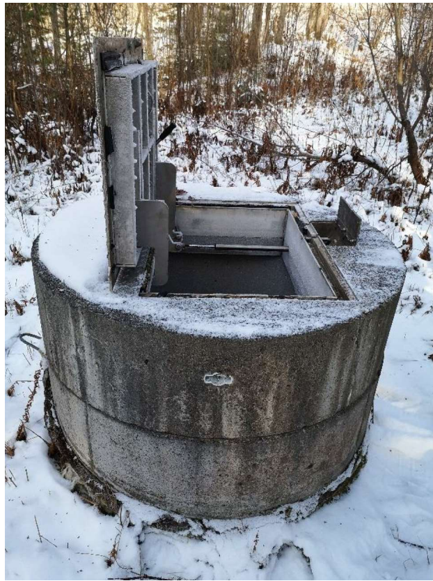
Figure 10 : Regard collecteur avec trappe d'accès
